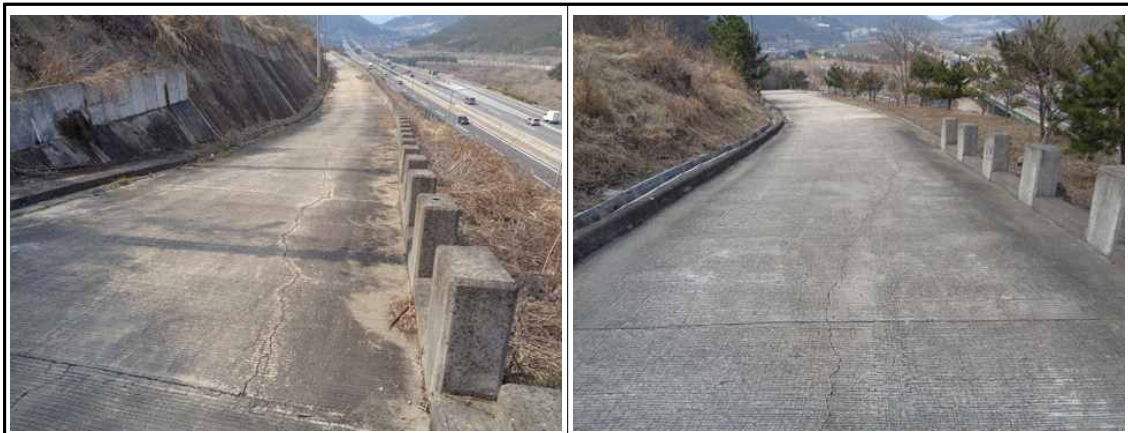
② 31.51K 배후도로 종균열 ⇨ 균열보수
