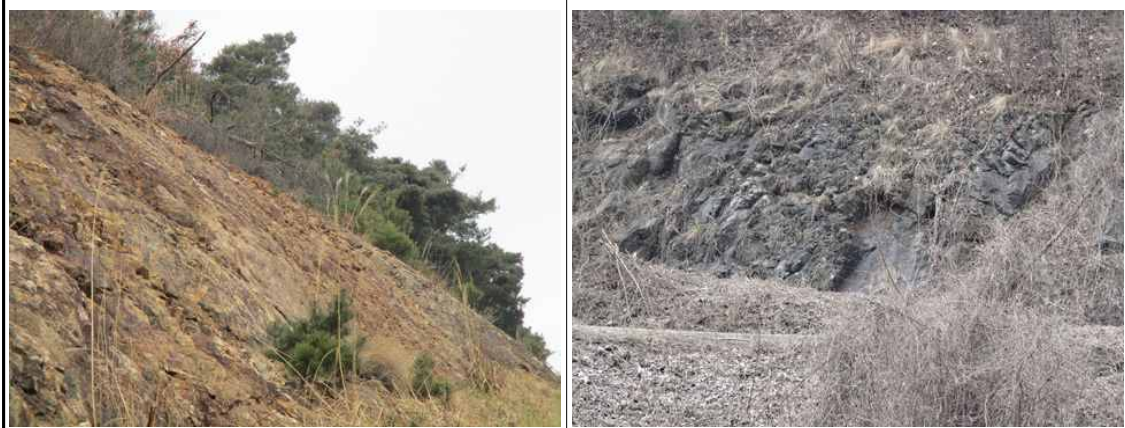
② 81.61K 상부자연사면 심한풍화, 이완암, 표층유실 ⇨ 주의관찰
